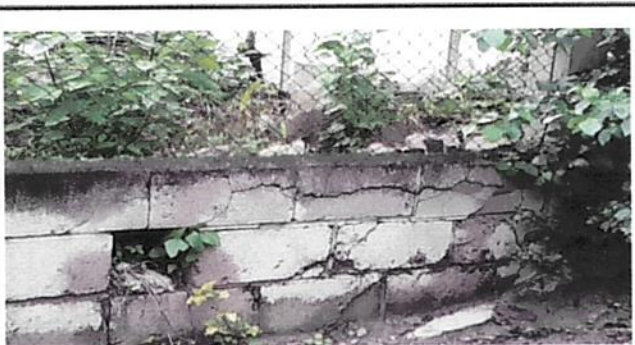
Foto 6: Agrietamiento y desplome del muro perimetral
