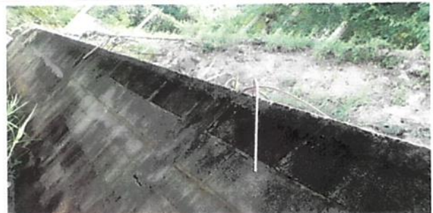
Foto 2: muro de contención en mal estado por la humedad
